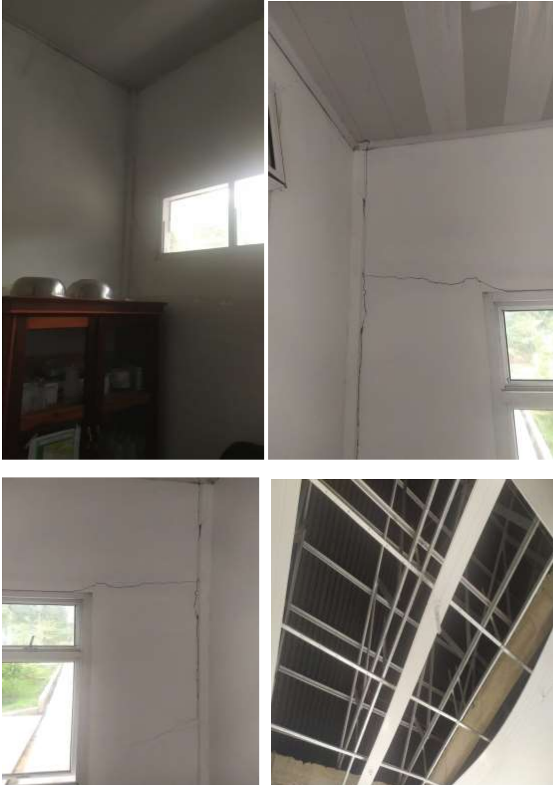
Gambar 8. Kerusakan bangunan berupa retakan (Sumber : WAG PUSGEN)
