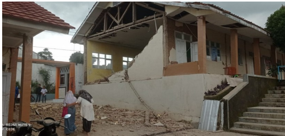
Gambar 9. Kondisi ruang kelas sekolah akibat gempa bumi Barat Daya Kabupaten Cianjur, Senin 21 November 2022 jam 13:21:10 WIB
