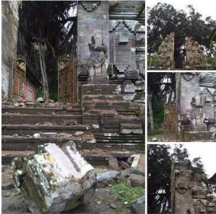
Gambar 6. Gambar kerusakan pada bangunan Pura Kehen, Bangli akibat Gempabumi Tenggara Denpasar Bali 22 Maret 2017 pukul 06:10:27 WIB
