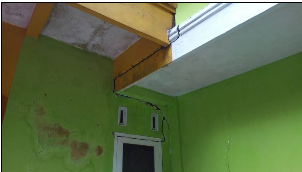
Gambar 6.4. Gambar kerusakan pada rumah warga akibat Gempabumi Barat Daya Tasikmalaya 24 April 2017 pukul 01:01:10 WIB
