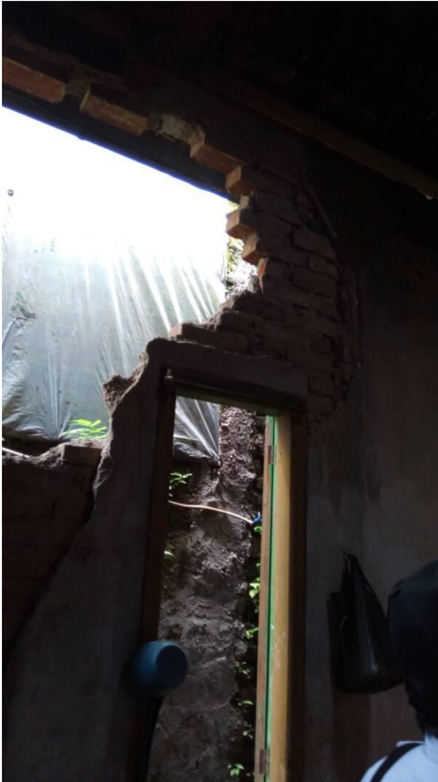
Gambar 6.10. Gambar kerusakan pada rumah warga akibat Gempabumi Barat Daya Tasikmalaya 24 April 2017 pukul 01:01:10 WIB
