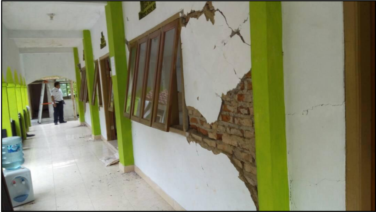
Gambar 6.2. Gambar kerusakan pada bangunan akibat Gempabumi Barat Daya Tasikmalaya 24 April 2017 pukul 01:01:10 WIB
