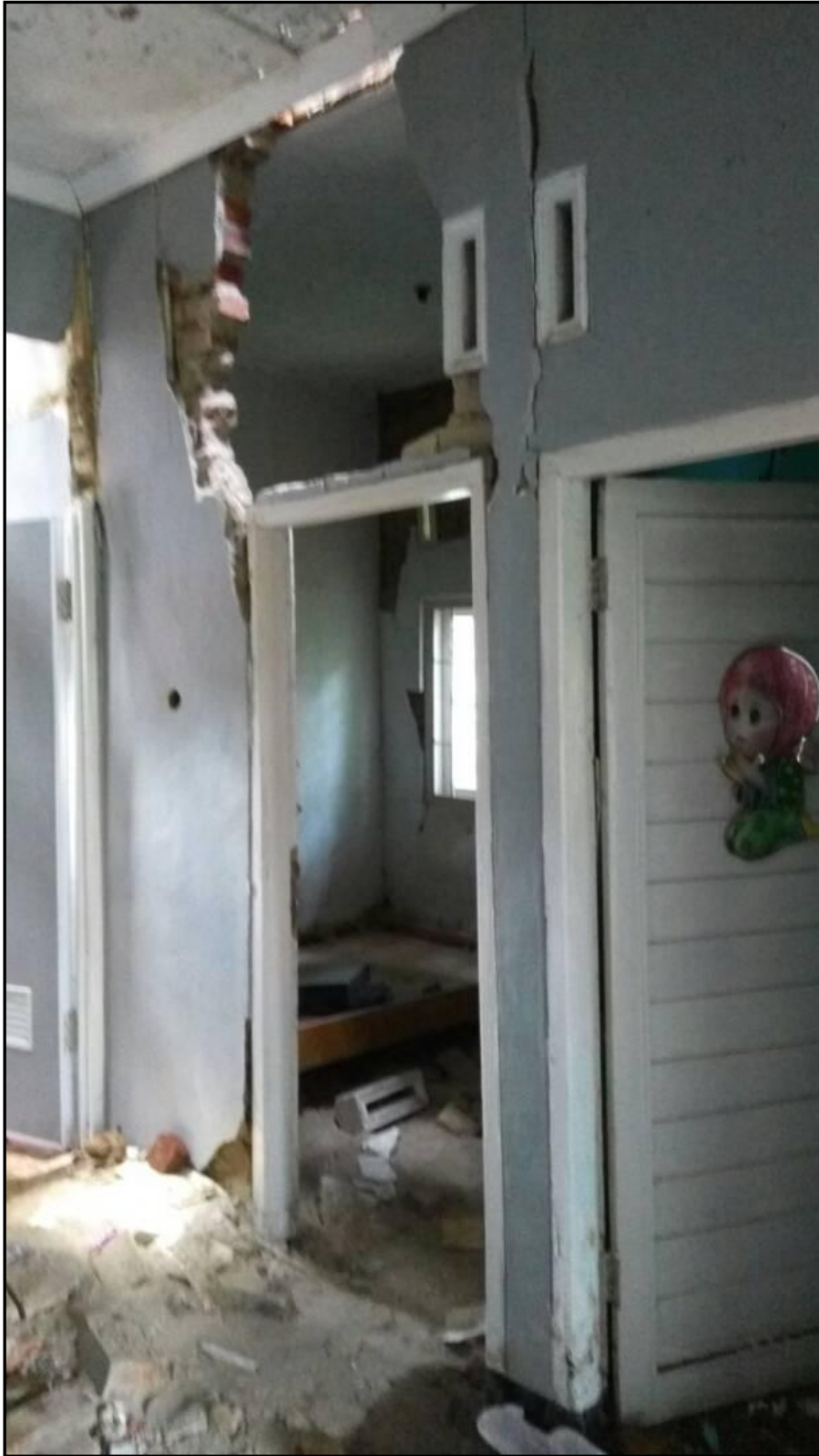
Gambar 6.9. Gambar kerusakan pada rumah warga akibat Gempabumi Barat Daya Tasikmalaya 24 April 2017 pukul 01:01:10 WIB
