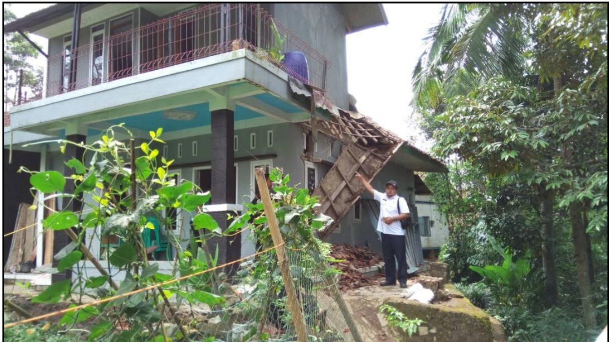
Gambar 6.3. Gambar kerusakan pada rumah warga akibat Gempabumi Barat Daya Tasikmalaya 24 April 2017 pukul 01:01:10 WIB
