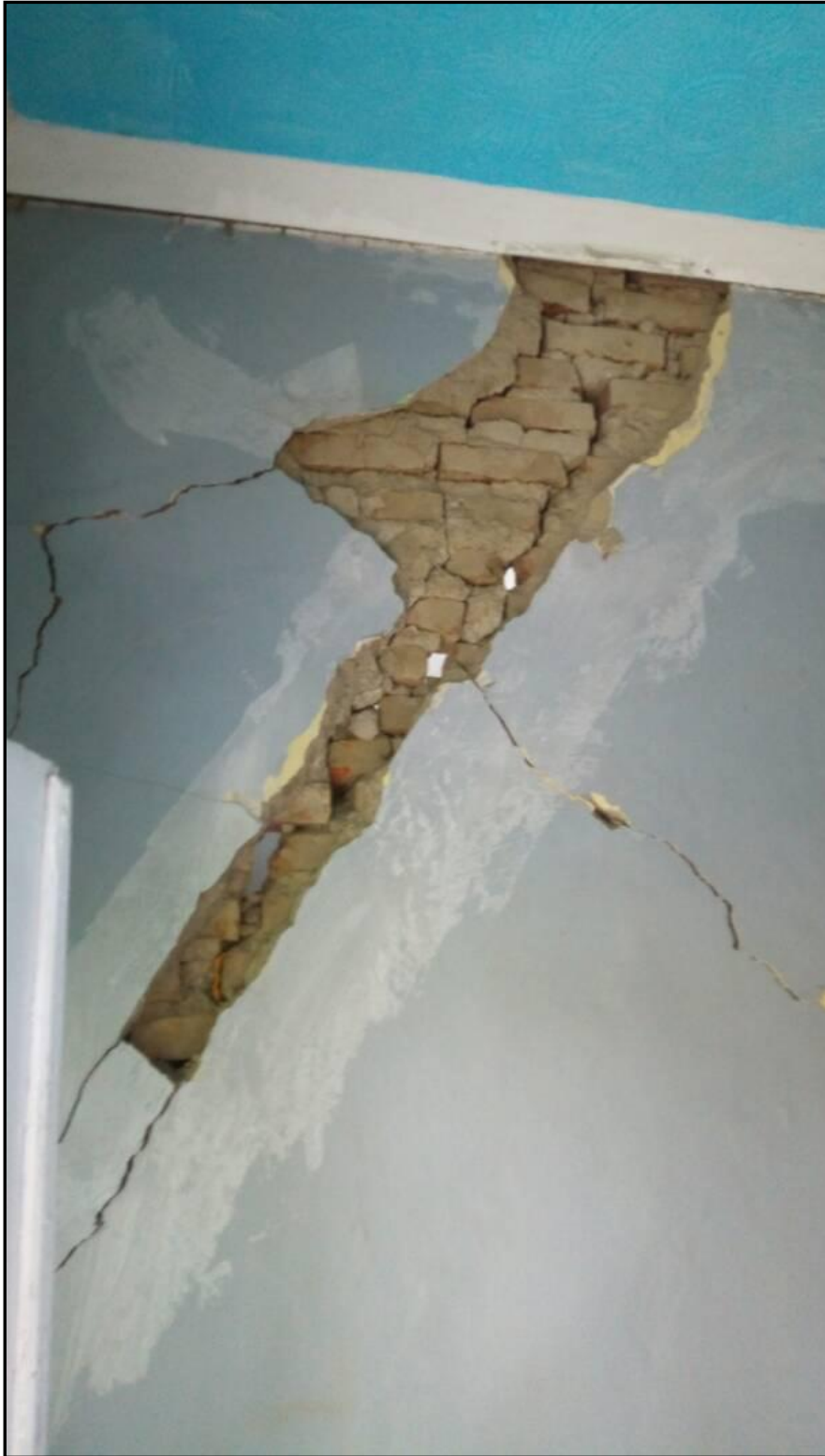
Gambar 6.8. Gambar kerusakan pada rumah warga akibat Gempabumi Barat Daya Tasikmalaya 24 April 2017 pukul 01:01:10 WIB
