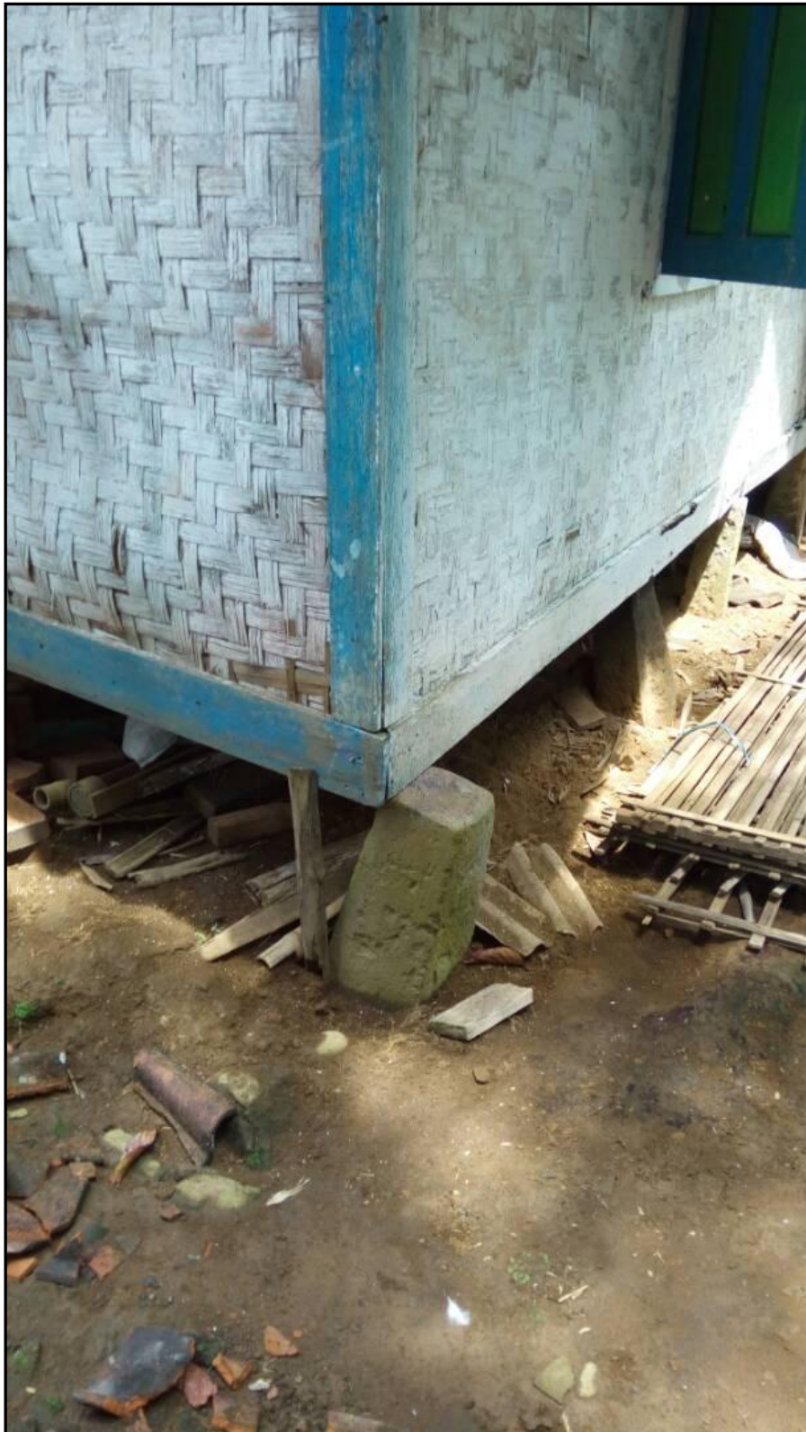
Gambar 6.1. Gambar kerusakan pada rumah warga akibat Gempabumi Barat Daya Tasikmalaya 24 April 2017 pukul 01:01:10 WIB
