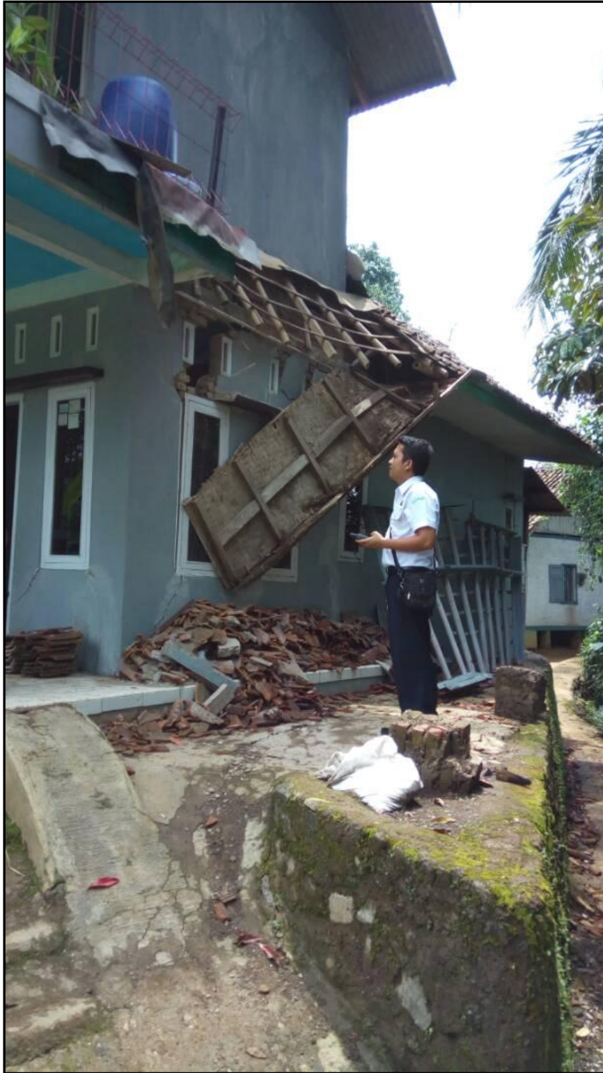
Gambar 6.7. Gambar kerusakan pada rumah warga akibat Gempabumi Barat Daya Tasikmalaya 24 April 2017 pukul 01:01:10 WIB
