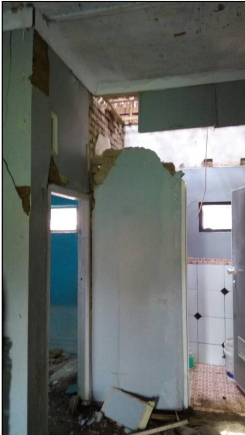
Gambar 6.6. Gambar kerusakan pada rumah warga akibat Gempabumi Barat Daya Tasikmalaya 24 April 2017 pukul 01:01:10 WIB
