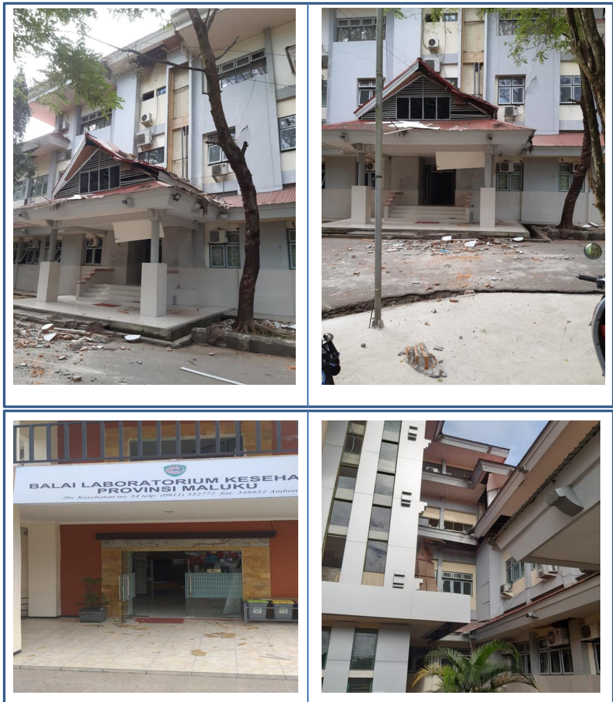
Gambar 7. Foto Bangunan yang mengalami kerusakan akibat gempa bumi Ambon 26 September 2019 (Sumber : Stakeholder BMKG di Ambon).
