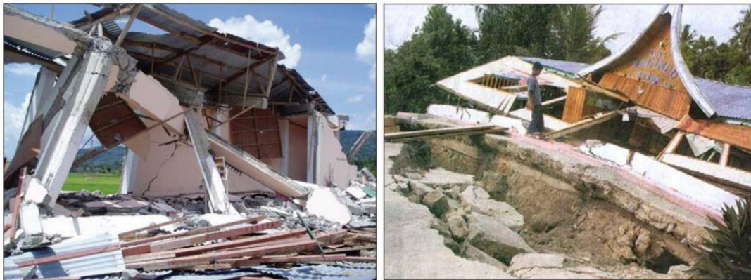
Gambar 1. Dokumentasi Kerusakan Bangunan Akibat Gempa di Kota Padang Panjang Pada Tanggal 6 Maret 2007 (Sumber : EERI Special Earthquake Report — May 2007)
